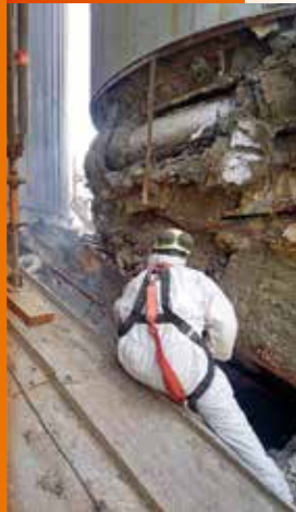
Recherche de fuite
